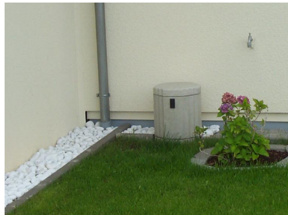
Bild 2: Beispiel einer Anschluss säule
